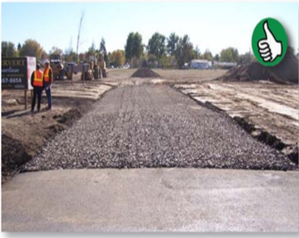
Un excelente ejemplo de una entrada de construcción estén correctamente instalados. (Source: Asotin County)
