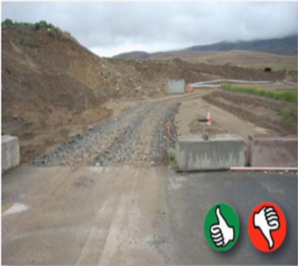
Buena instalación de una entrada de la construcción, pero el sedimento se rastrea todavía fuera del sitio. Agregar más rockero o hacer la entrada más larga. (Source: Douglas County)
